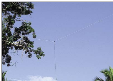
Der Einspeisepunkt einer der Horizontal-Antennen in etwa 15 m Höhe
